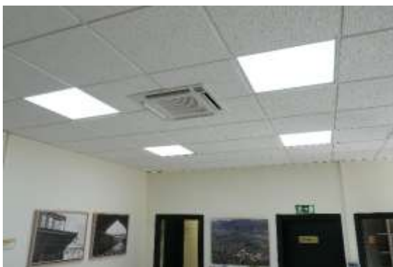
Luminarias LED en pasillo
