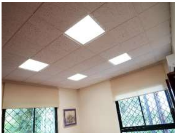
Luminarias LED en Sala de reuniones
