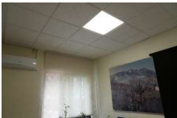
Luminaria LED en despacho
