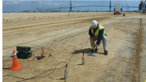
Figura 8. Ensayo de análisis espectral de ondas superficiales, con fuente de impactos manual, en el Puerto de Cádiz.
