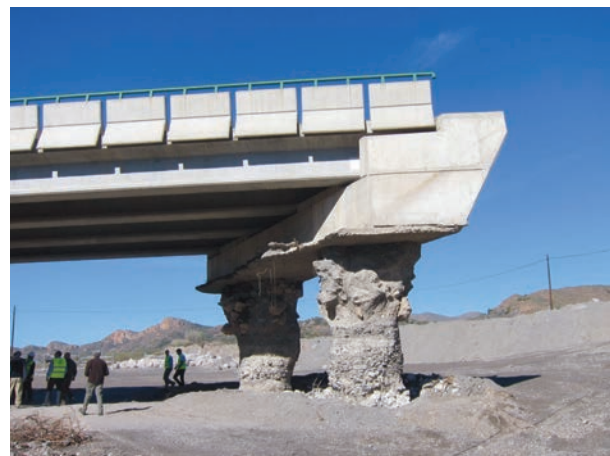
Figura 4. Estudio de patologías en obras de carreteras. Viaducto en la A-7.
