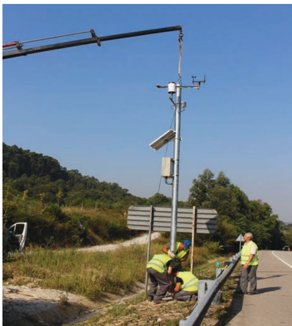
Figura 2. Instalación de una estación de medida de variables meteorológicas.
