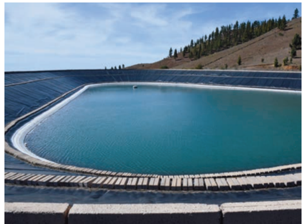
Figura 9. Seguimiento del comportamiento de geomembranas en balsas. Balsa de Trevejos (Tenerife).
