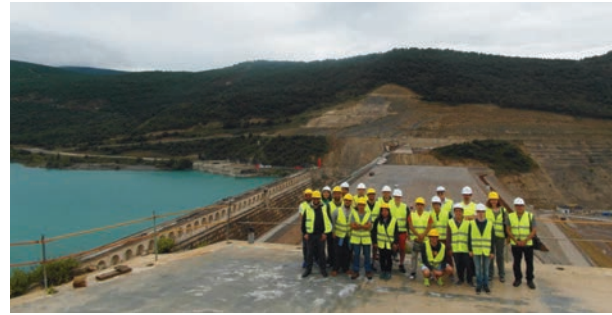
Figura 14. Visita de los alumnos del Master de Mecánica del Suelo e Ingeniería Geotécnica a las obras de recrecimiento de la Presa de Yesa.
