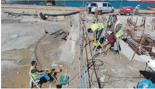
Figura 9. Ensayos Cross-hole en las pantallas de la zona de Pañoles del Puerto de Cádiz.
