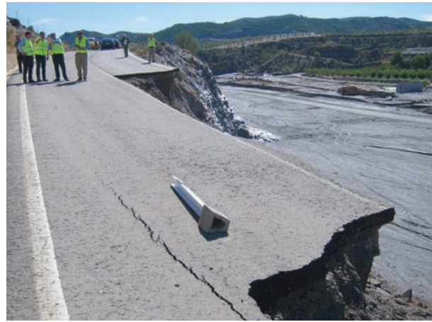
Figura 3. Estudio de patologías en obras de carreteras. Rambla de Nogalte.
