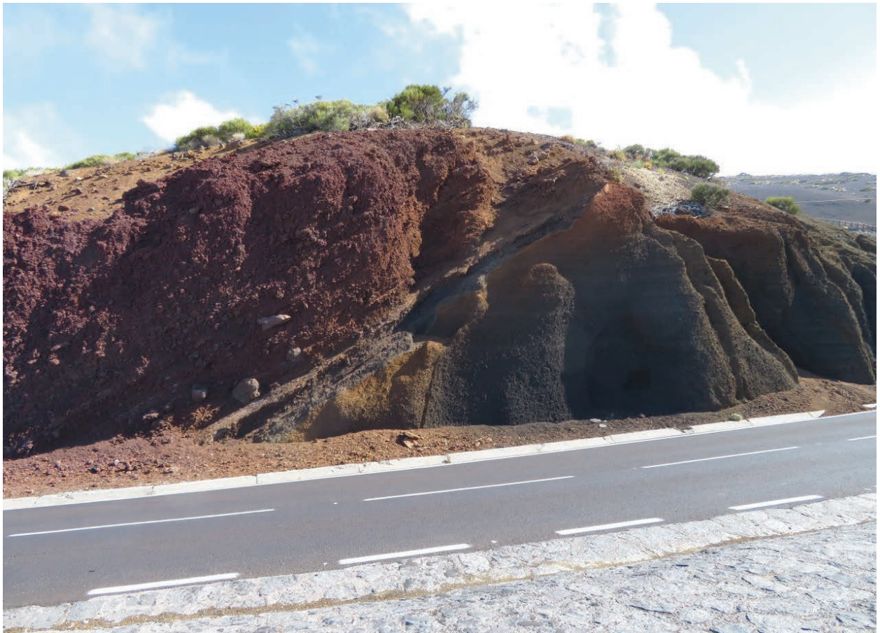
Figura 1. Talud en materiales piroclásticos. Estudio del desarrollo de una clasificación geomecánica para evaluar el riesgo de inestabilidad de taludes en los materiales volcánicos de las islas Canarias.
