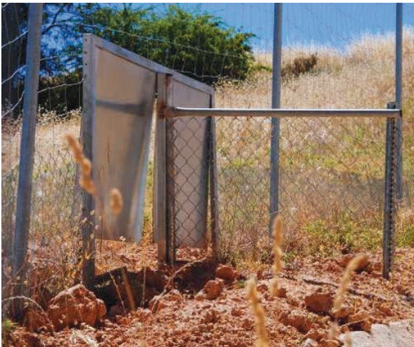
Figura 5. Defectos en la instalación o en el diseño de los portillos de escape pueden dar lugar a que constituyan puntos de entrada de animales a la infraestructura.
