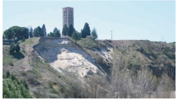
Figura 11. Estudio de las inestabilidades del talud situado en la margen izquierda del río Eresma a su paso por la localidad de Coca (Segovia).
