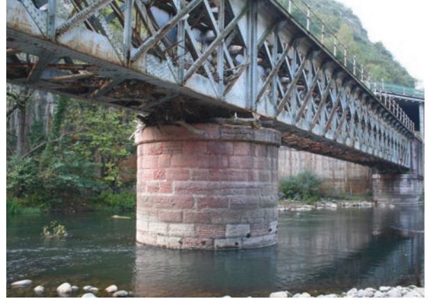
Figura 6. Estudio geológico-geotécnico de puentes históricos para el ADIF. Puente sobre el río Caudal en Parteayer (Asturias).
