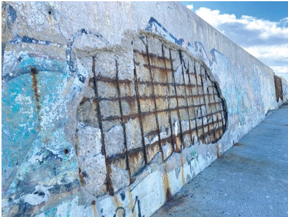
Daños típicos en estructuras costeras.
