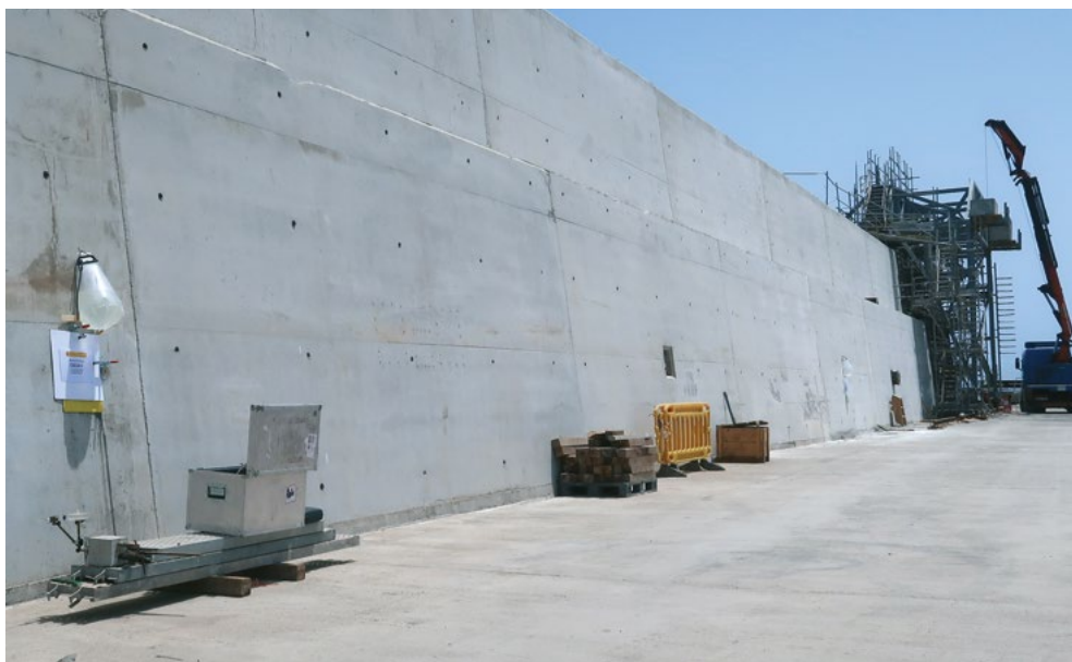
Ensayos de durabilidad para el control de la ejecución de hormigones portuarios. Fase III del dique Reina Sofía. Puerto de Las Palmas.
