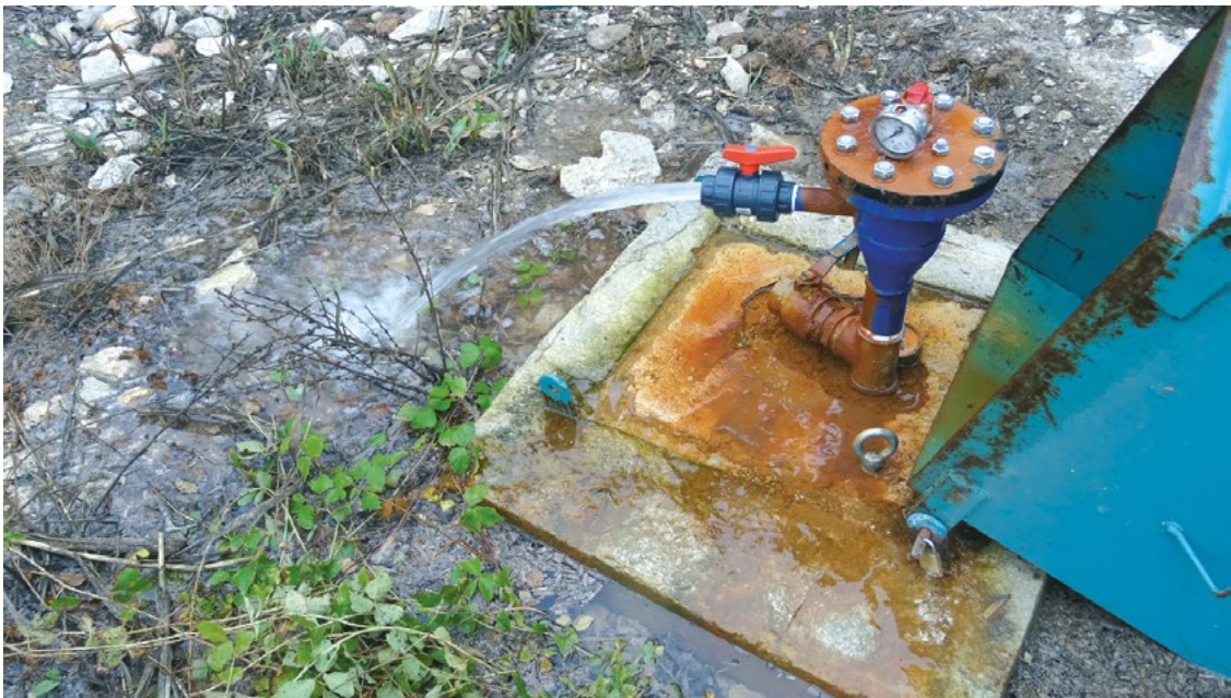
Sondeo surgente acondicionado como piezómetro, punto de registro continuo y punto de muestreo situado en un acuífero localizado aguas abajo del embalse de Bellús.
