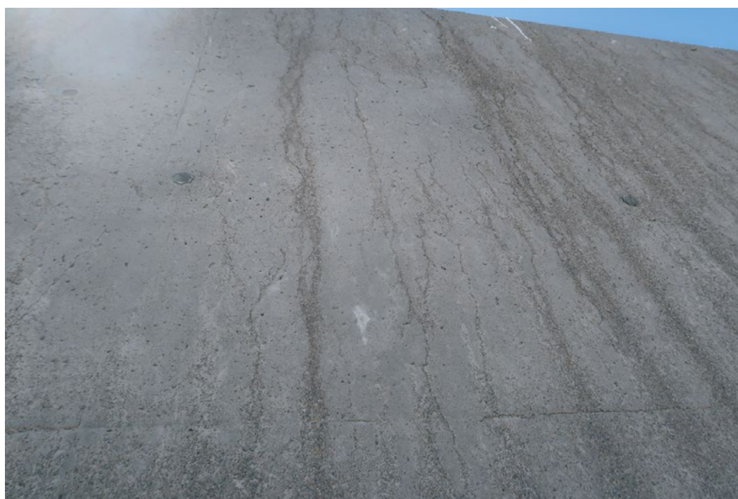
Defectos de compactación en el recubrimiento (regueros en superficie).
