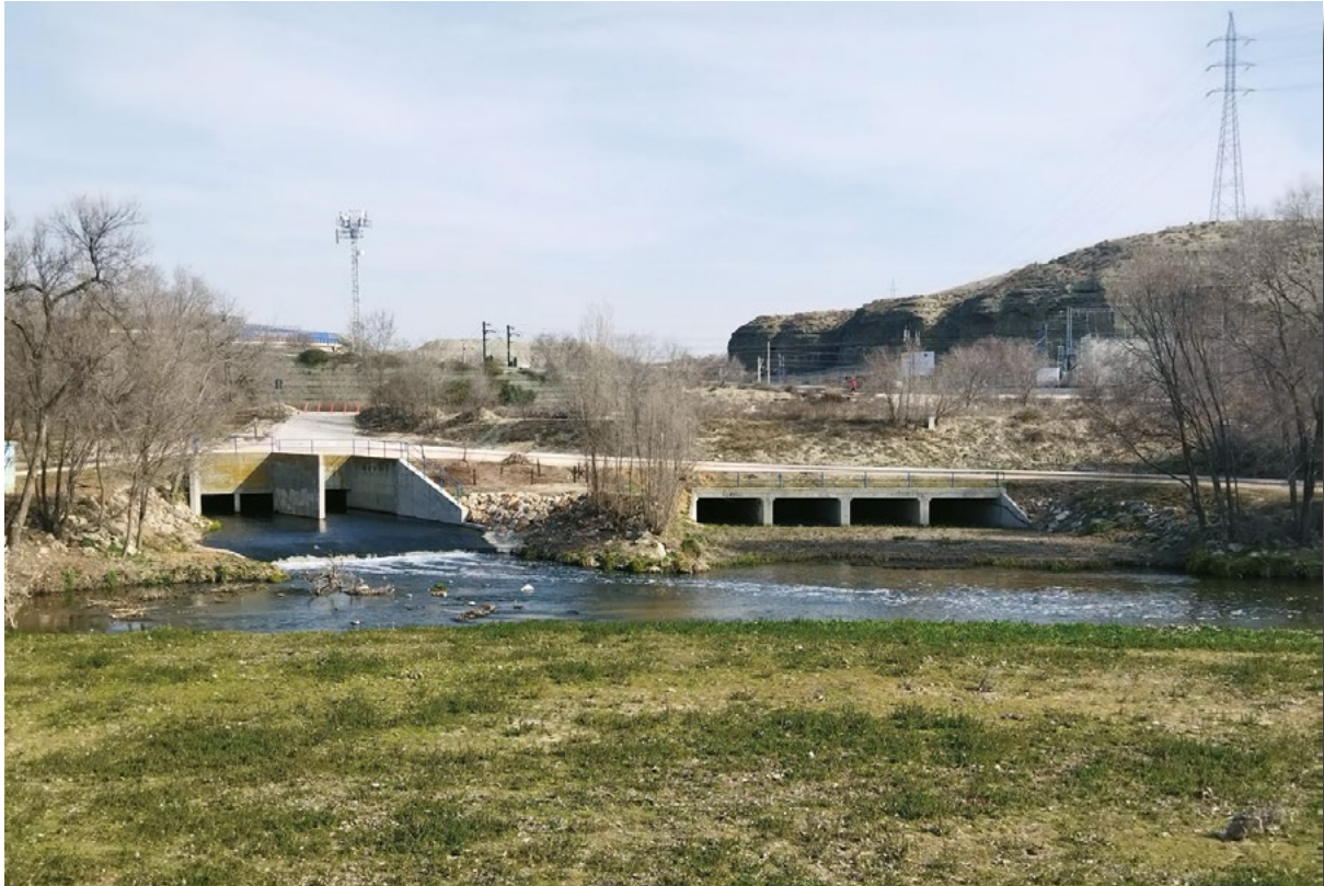
Aliviaderos de la EDAR de La Gavia y del arroyo de La Gavia, en la margen izquierda del río Manzanares.
