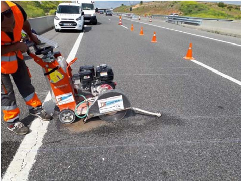
Ejecución del corte en el pavimento Para realizar la ranura donde se aloja el sensor de peso
