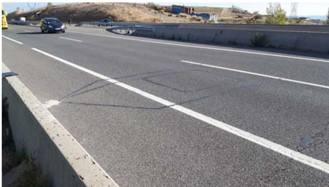
Vista de los sensores del sistema de pesaje con la calzada abierta al tráfico el día de la calibración
