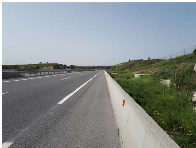
Tramo de instalación recto y llano
