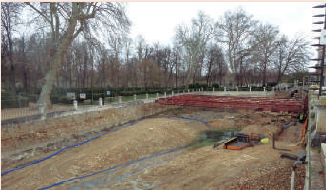
Inicio de las obras en la ría del palacio real de Aranjuez (diciembre 2019).
