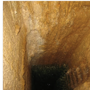
Costras de carbonato cálcico en pozos.
