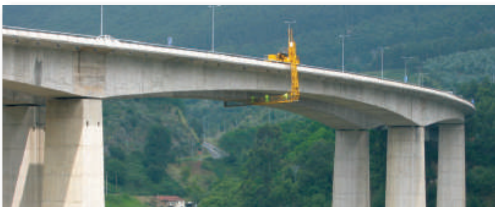
Inspección del viaducto de la A8 sobre la ría Agüera en Asturias.
